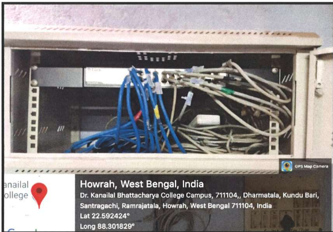
Old Internet Switch Box (LAN Distribution)
